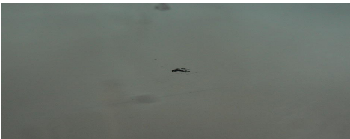
FOUT: Sterreparatie voldoende gevuld maar oppervlakte niet afgewerkt.
